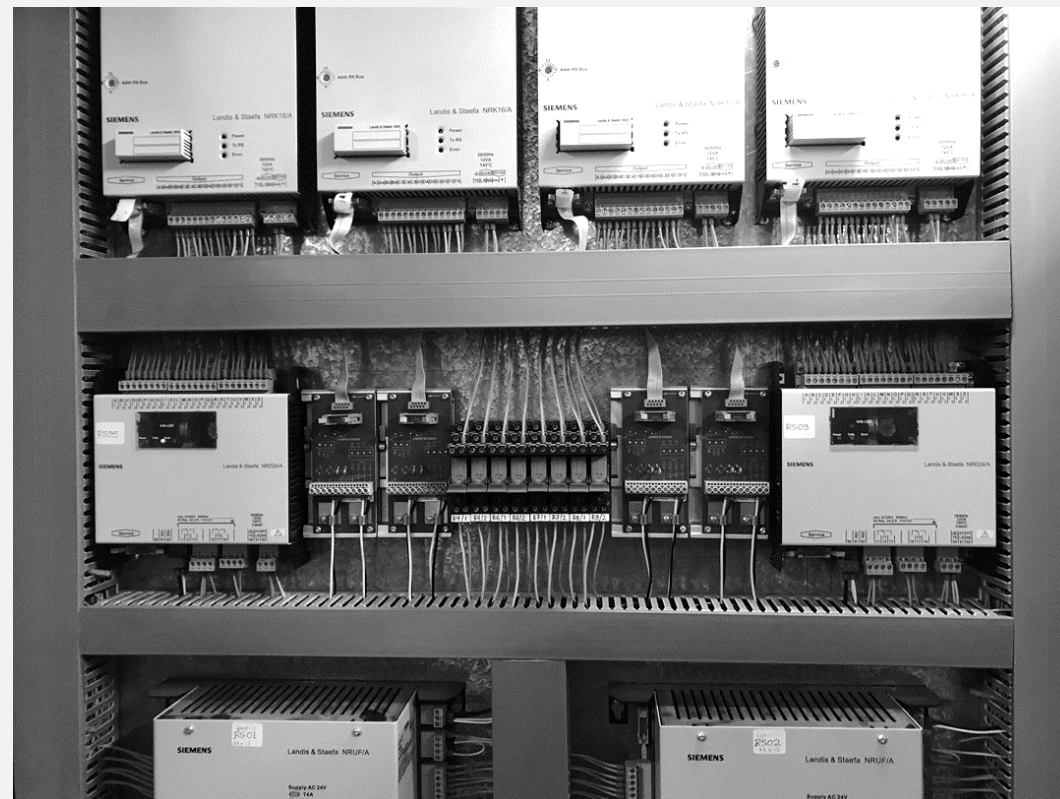
Παλιά εγκατάσταση συστήματος κτιριακού αυτοματισμού
